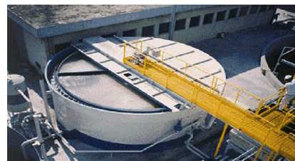
Tanque de separador por flotación
